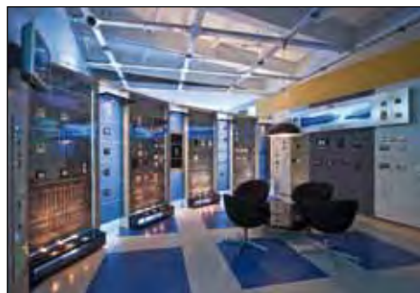
Im Show-room ist für jedes mit KNX gesteuerte Gewerk eine Schautafel aufgebaut.
